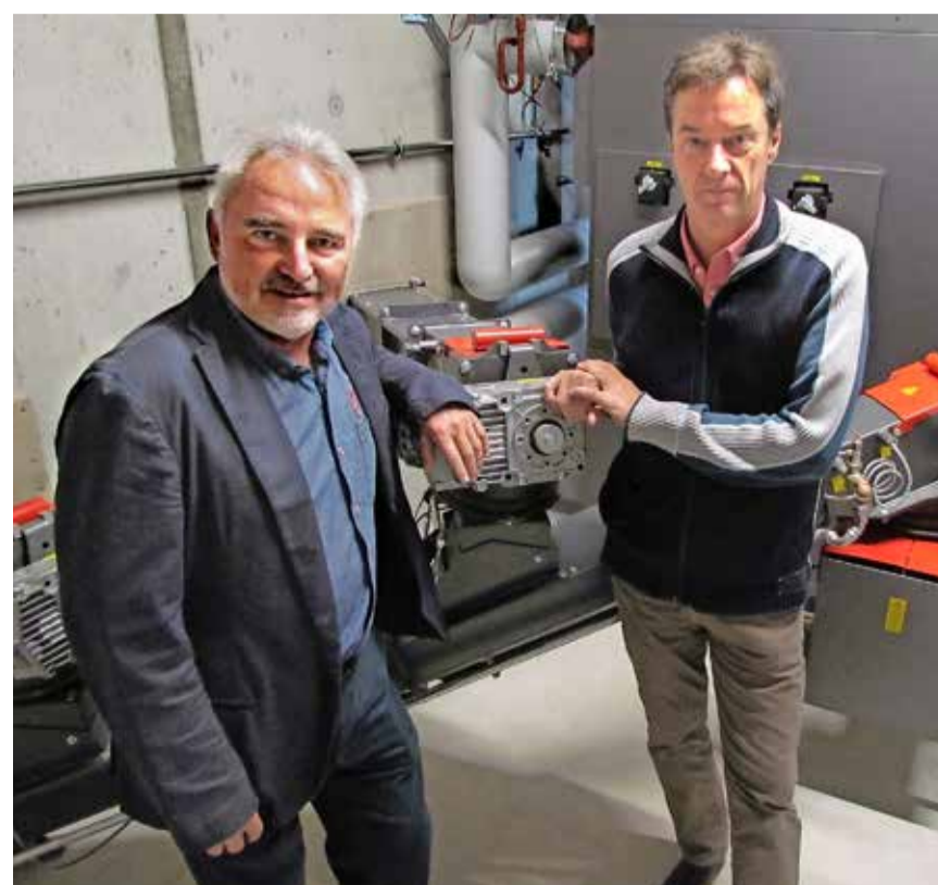
Gemeindepräsident Claus Ullmann (links) und Projektleiter Philippe Rimbeaux vor einem der neuen Heizöfen mit den Anschlüssen der Schnitzelkanäle.
